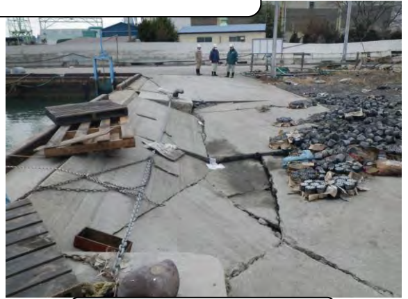
岸壁の被害状況
